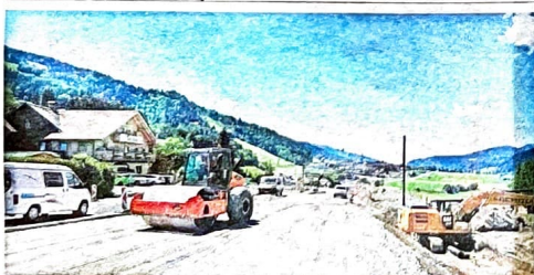
In Haus wird die „verlegte“ B 320 asphaltiert. Das Großbauvorhaben „Trassenabrückung Ennsling“ schreitet voran.
